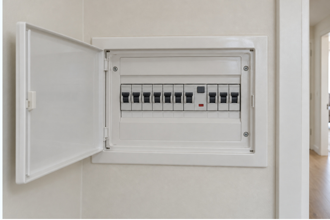
F15 Elektrik panosu
